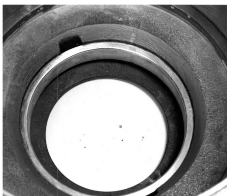
Obrázek 10: Třecí kruh ve skříně čerpadla
