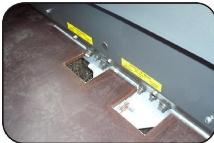
Obr. 15 Díry v podlaze pro výpustné ventily
