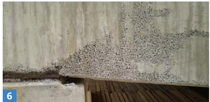
6 Štěrkové hnízdo, odtok cementového mléka
