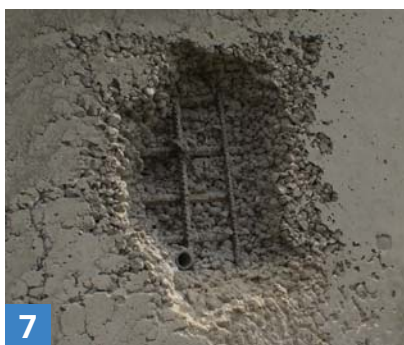
7 Obnažená armatura a štěrkové hnízdo
