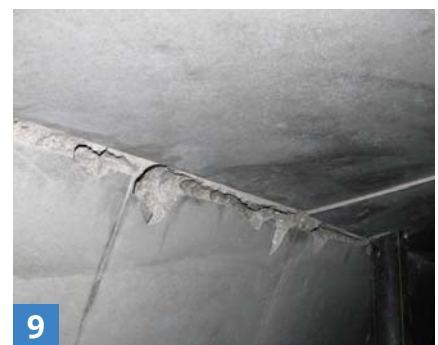
9 Prohlubně po PU pěně
