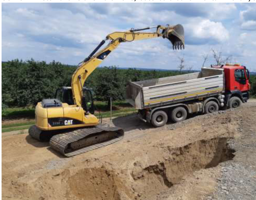
Obr. č. 4 Místo havárie dne 16.6.2020, odtěžba a odvoz kontaminovaných zemin
