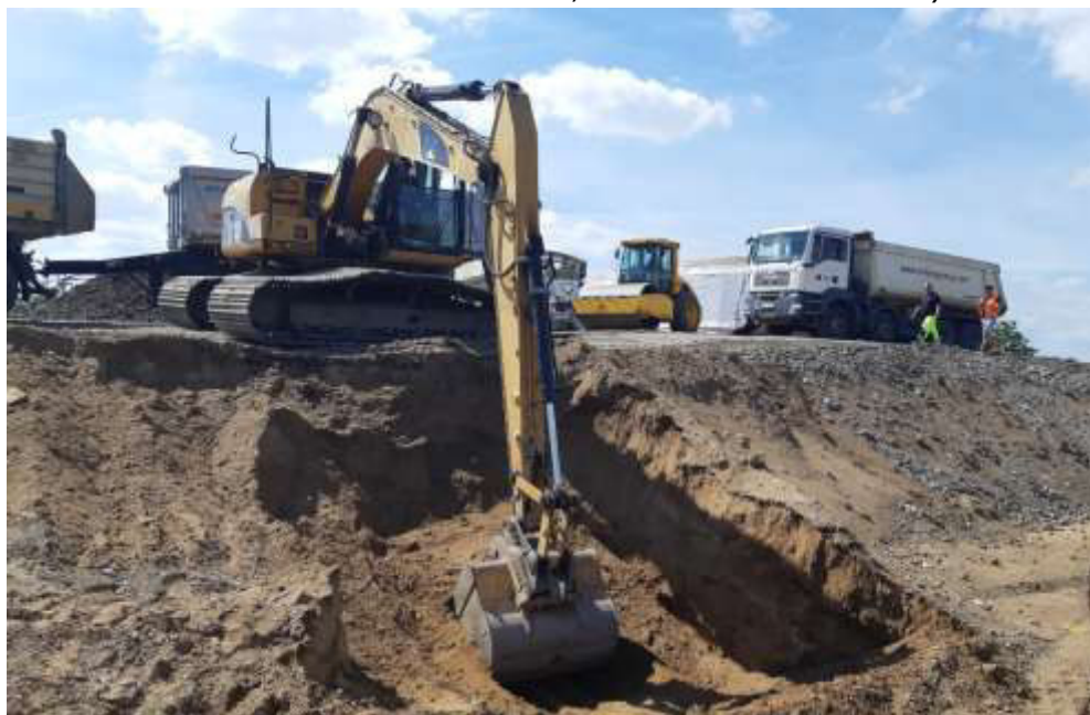
Obr. č. 3 Místo havárie dne 15.6.2020, odtěžba kontaminovaných zemin
