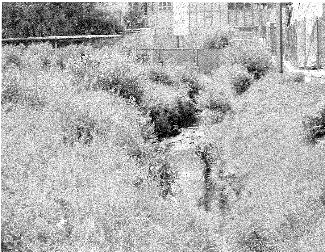
Obrázek 1: Zbytky opevnění na pravém břehu v ř.km 0,150 (pohled proti proudu)
