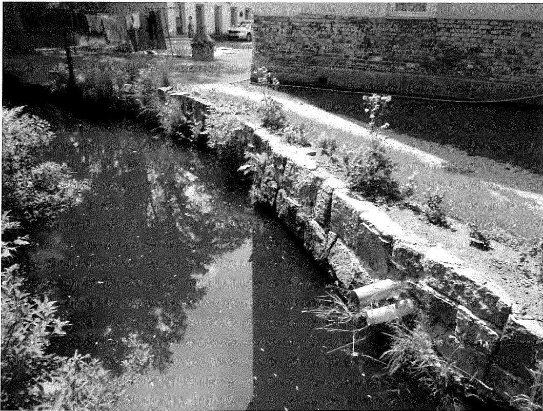
Obrázek 5: Lesní potok u bytového domu ř.km 0,370 - LB (proti proudu)
