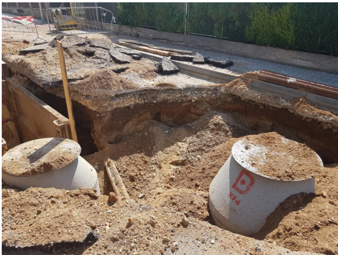
Obrázek 2 - sesuv v místě křížení s VTL plynovodu
