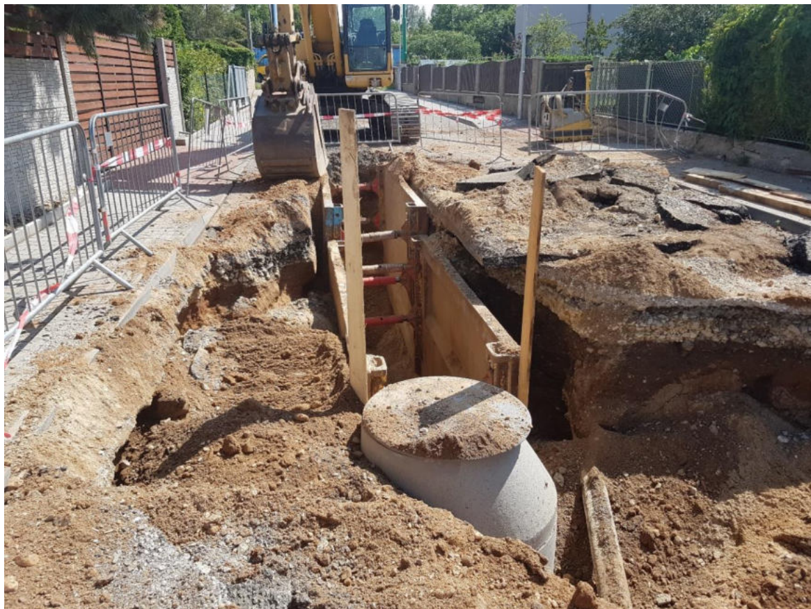
Obrázek 1 - sesuv v místě šachty č. 3 a č. 4
