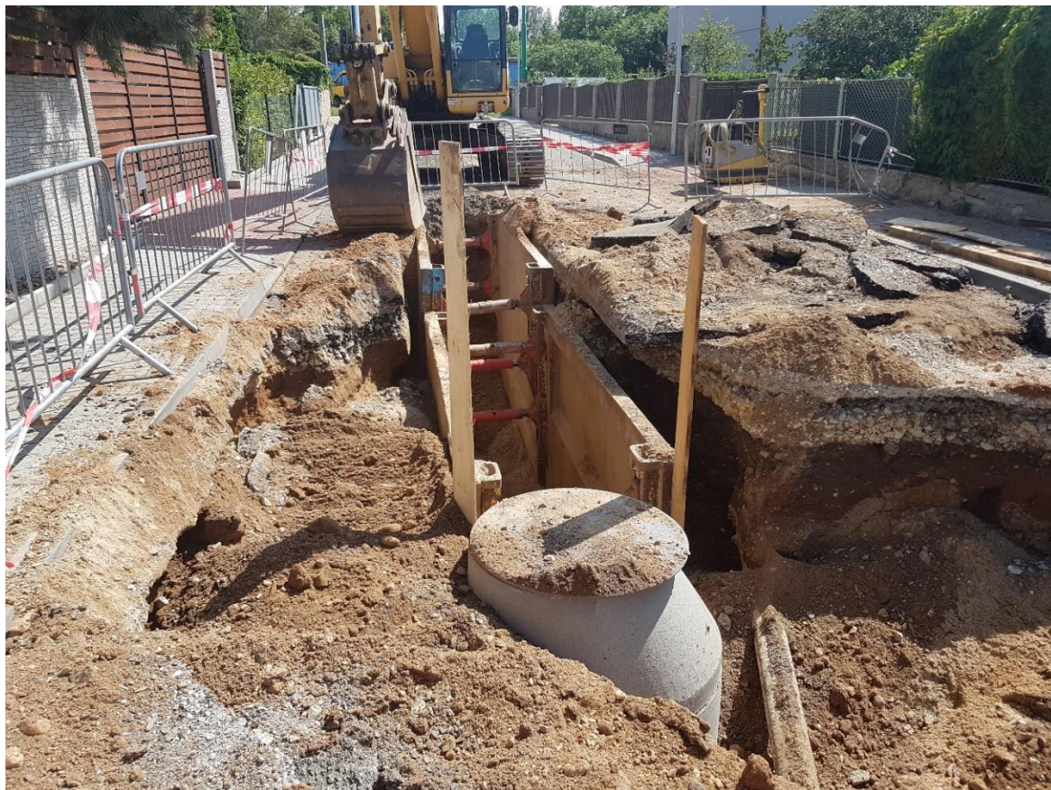
Obrázek 1 - sesuv v místě šachty č. 3 a č. 4
