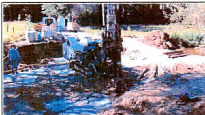
Obr.č. 1 : Pohled do stavební jámy s hloubenou kontrolní – 2. v pořadí - mikropilotou 005 na pravobřežní opěře OP2 v celkové vrtné délce 4,2 m.
