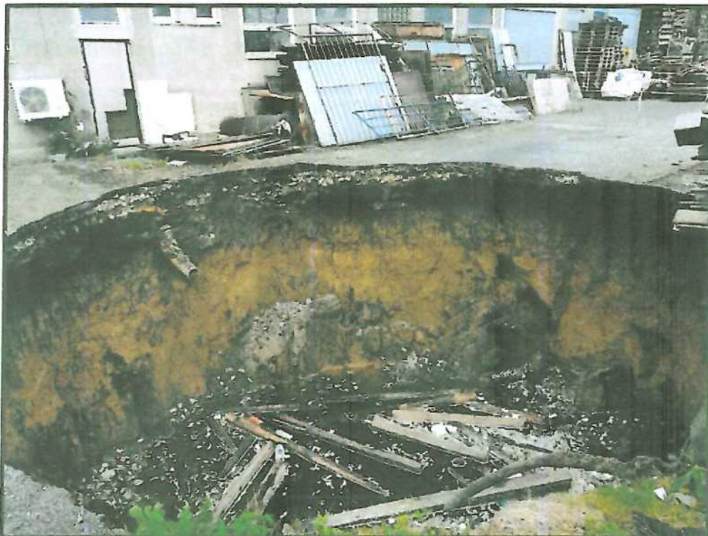
Foto č. 3 propadu do jámy – detail severním směrem (7.9.2020)
