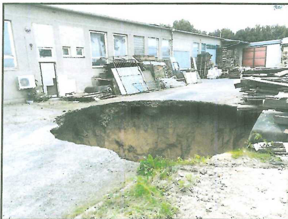
Foto č. 1 propadu do jámy - severním směrem (4.9.2020)
