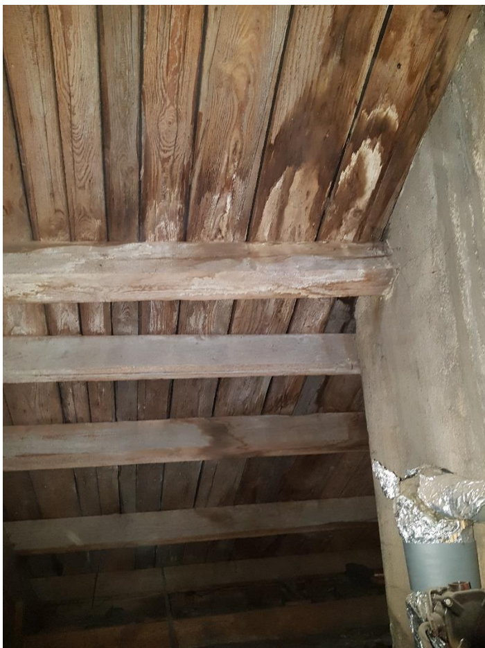
Obr. 11: Severovýchodní část krovu u komína nad schodištěm. Protečené místo podbití, hnědá hniloba.
