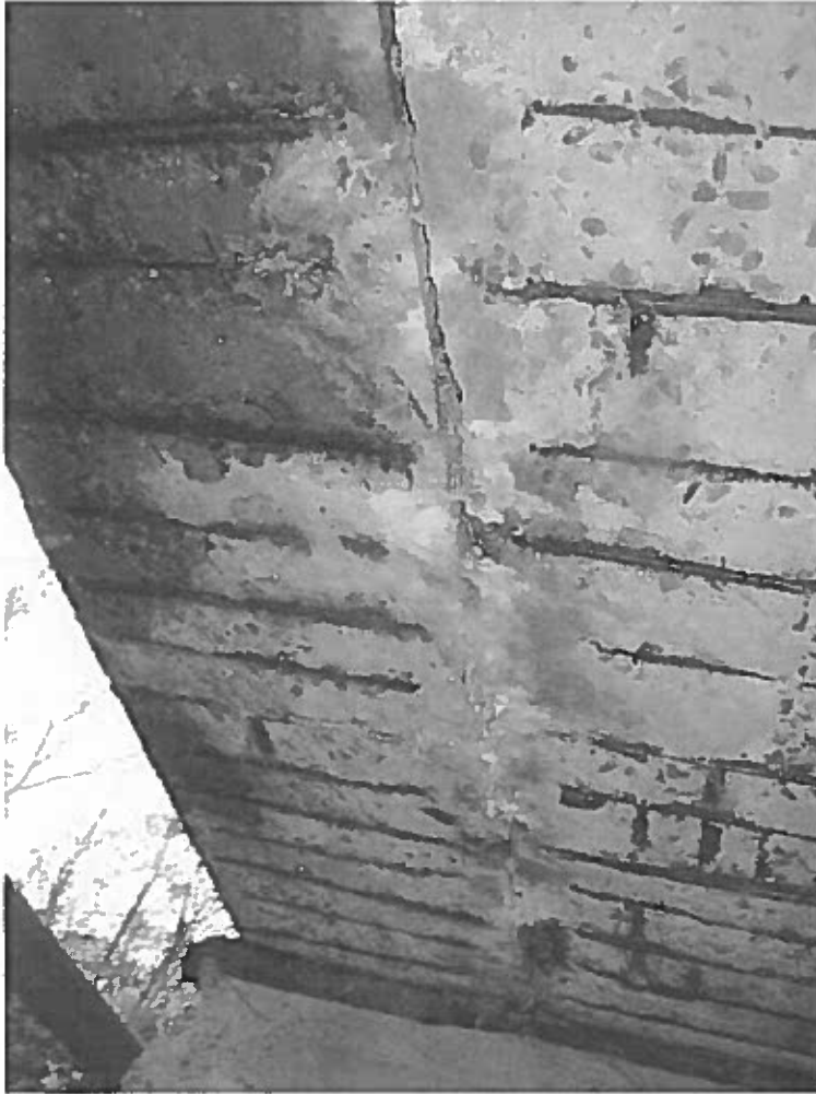
Podhled NK - ztékání z říms a spárami mezi nosníky
