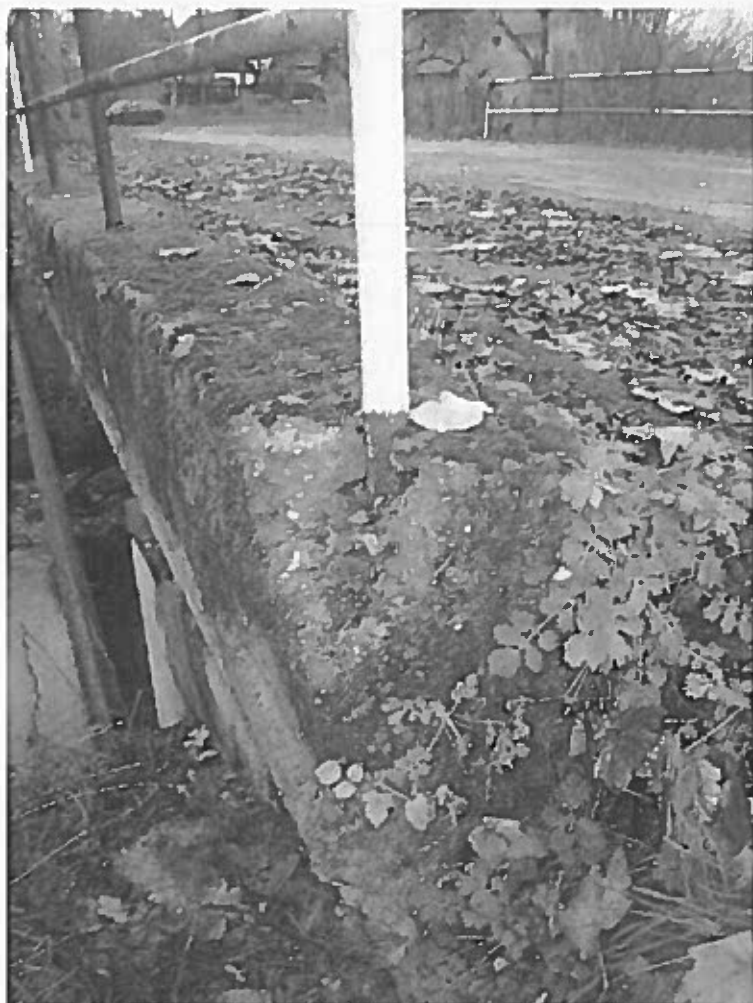
degradace říms, korze sloupku zábradlí
