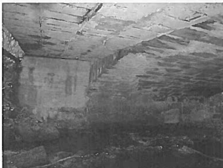
OP1 - zatékání v rozšíření, koroze výztuže rozšíření NK, výluhy na podhledu klenby
