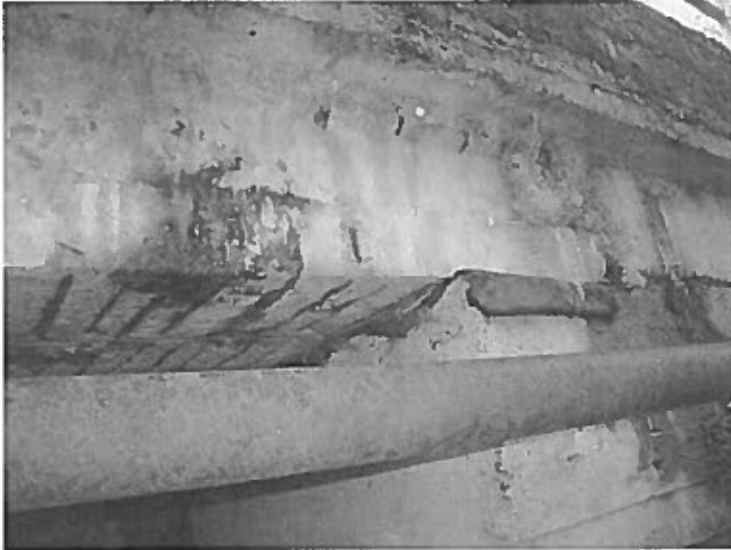
Uložení nosníků, chránička, zatékání na bok NK s výluhy, obnažená korodující výztuž
