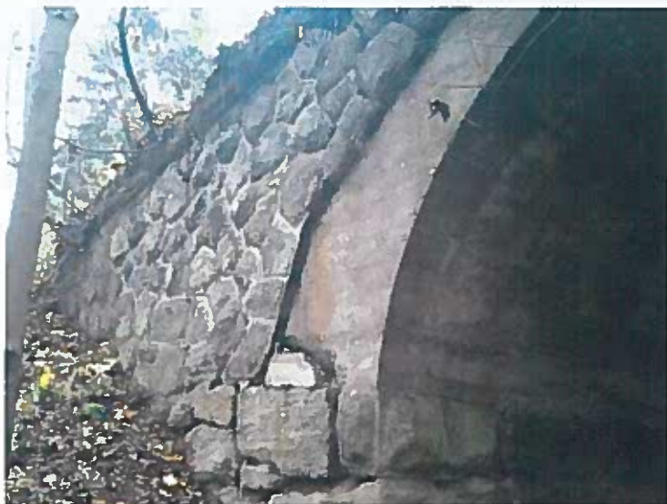
Vysunutí čelních zdí a poruchy v patě klenby - vtok
