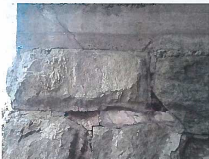
Poruchy v patě klenby - vtok
