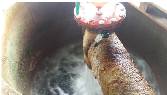
Obr. 20 Fotografie z místního šetření, pohled na dávkování chemikálii v nadzemní části PPPV
