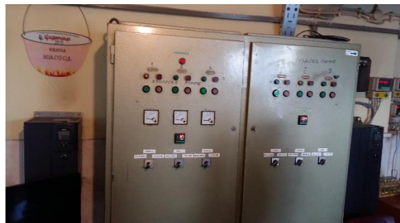
Obr. 27 Fotografie z místního šetření, nadzemní část PPPV, velín, rozváděče
