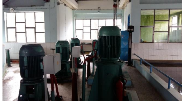
Obr. 23 Fotografie z místního šetření, nadzemní část PPPV, čerpadla
