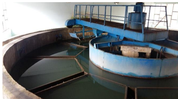
Obr. 21 Fotografie z místního šetření, pohled na úpravu vody v nadzemní části PPPV
