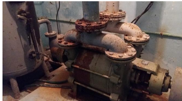
Obr. 17 Fotografie z místního šetření, pohled na armaturní část PPPV
