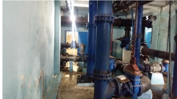
Obr. 15 Fotografie z místního šetření, pohled na armaturní část PPPV
