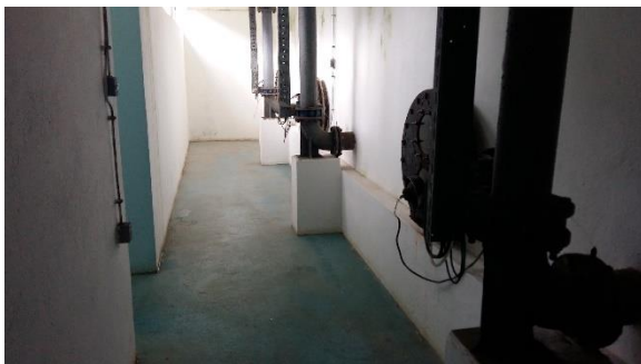
Obr. 18 Fotografie z místního šetření, pohled na armaturní část filtrů PPPV
