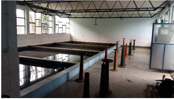
Obr. 22 Fotografie z místního šetření, nadzemní část PPPV, filtry
