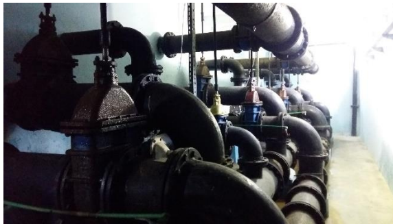
Obr. 16 Fotografie z místního šetření, pohled na armaturní část PPPV
