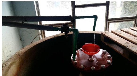
Obr. 19 Fotografie z místního šetření, pohled na dávkování chemikálii v nadzemní části PPPV
