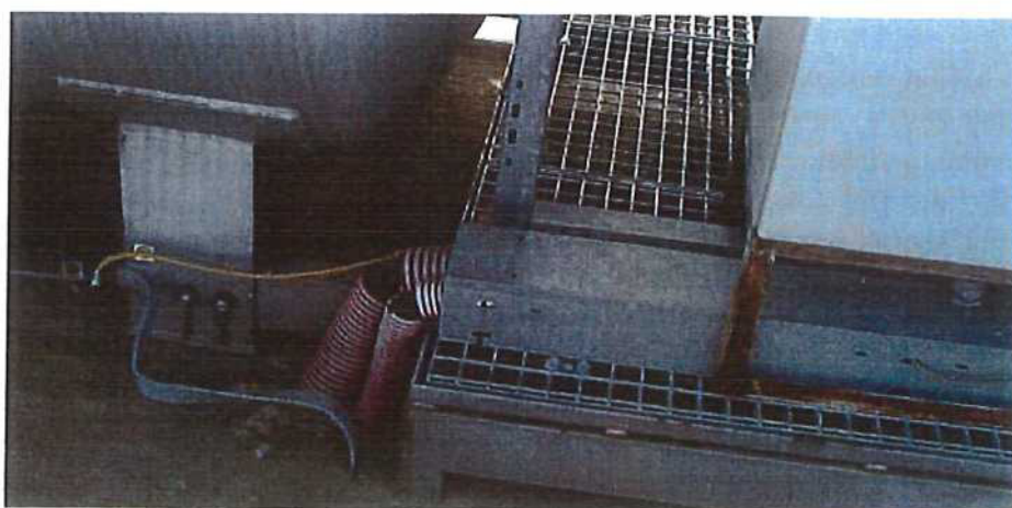
... místo s přípojkami / rozvaděč umístěn na „odvrácené“ straně od heliportu
