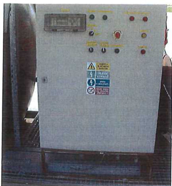
... stávající skříňový rozváděč
