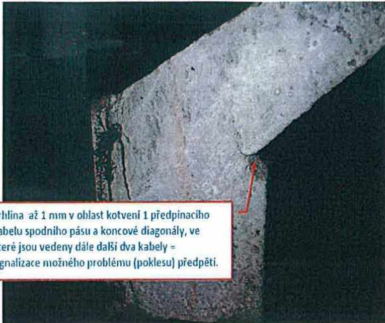
Foto 2: Pohled na kotvení oblast na kraji spodního pásu. Trhlina signalizuje možný konstrukční problém z hlediska sníženého a nedostatečného předpětí.
