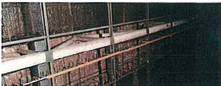
Foto 1: Pohled na spodní pás. Na pás je připevněna konstrukce podhledu a obslužné lávky. V místě styčnicků vazníku jsou plechy, které ztěžují kontrolu stavu předpínací výztuže v místě styčných spár.
