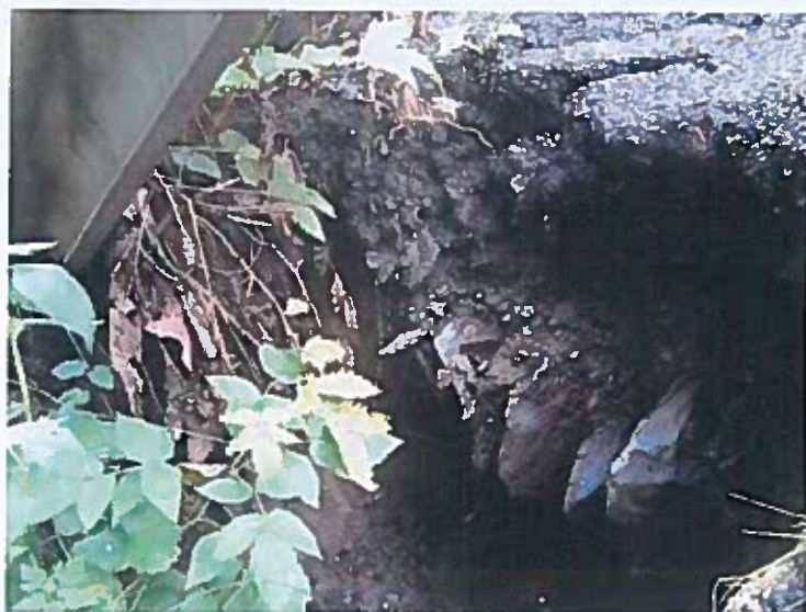
Podemletá krajnice a zničené křídlo.
