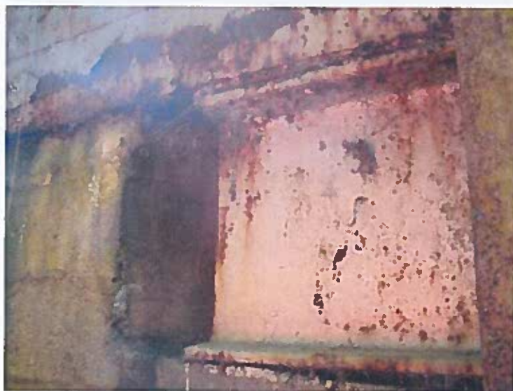
Koroze ocelových nosníků a římsy
