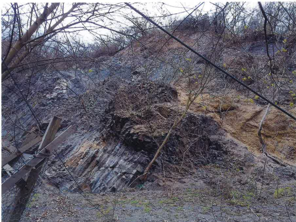
Obrázek 9 Stav skalního masivu za dočasnou bariérou
