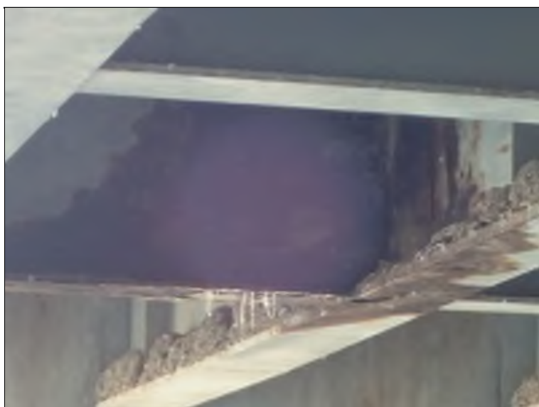
Pole 3, pohled NK, detail intenzivní koroze v úseku za pilířem P3.
