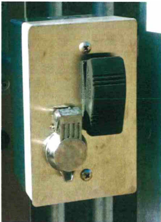
Přivolávací na dolní podestě
