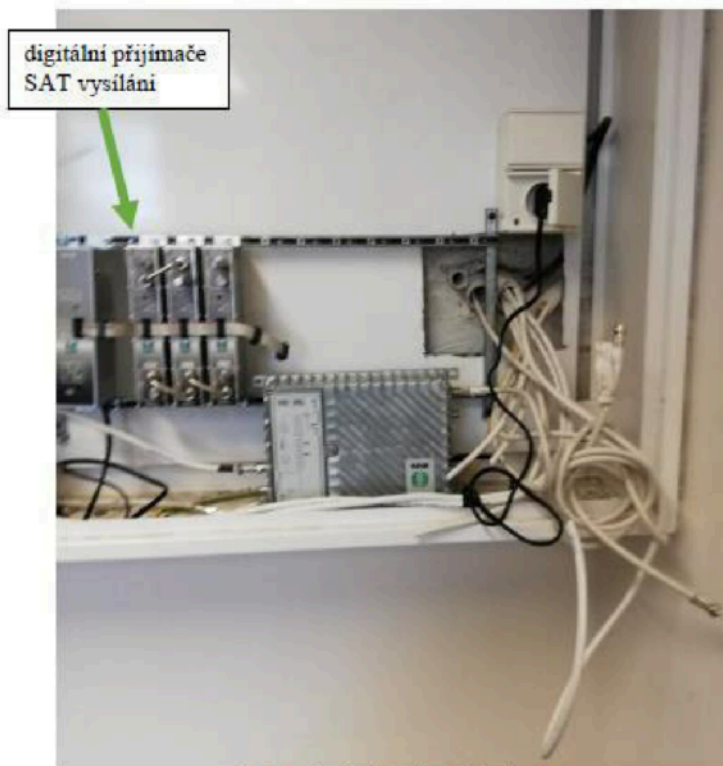
Obr. č. 6 Hlavní televizní stanice budovy 22
