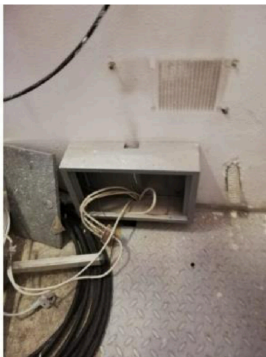
Obr. č. 10 rozvaděč v budově 3
