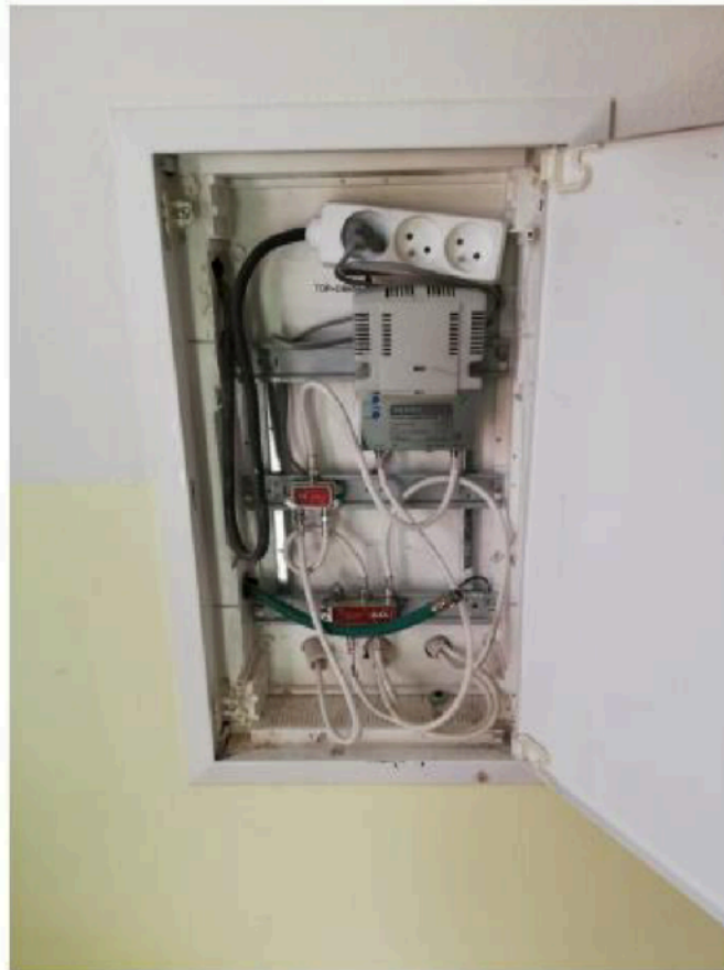
Obr. č. 12 rozvaděč v budově 2
