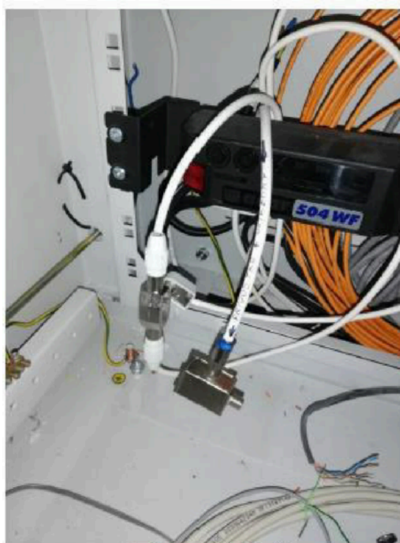
Obr. č. 11 rozvaděč v budově 1
