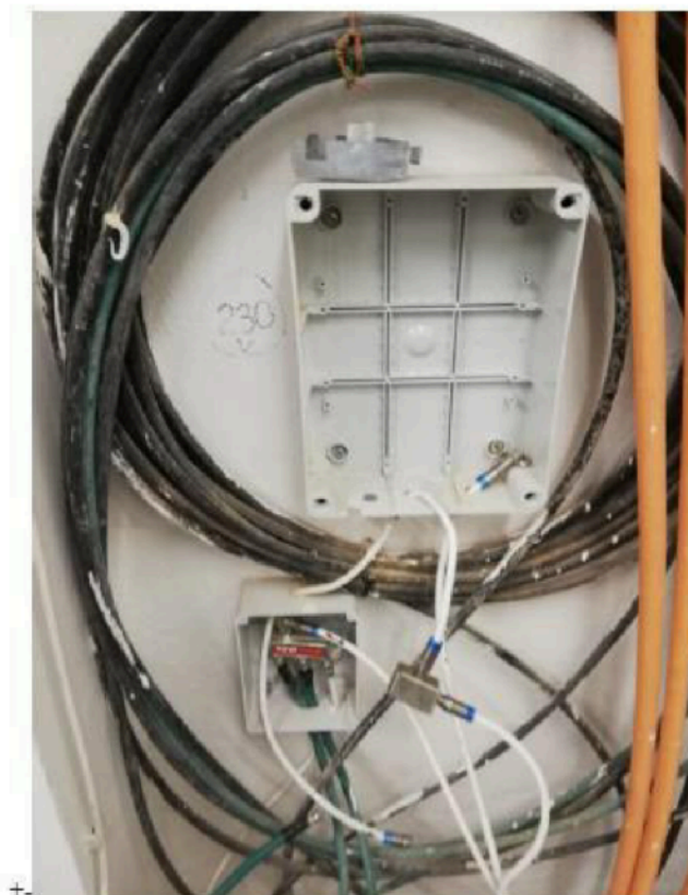
Obr. č. 9 rozvaděč v budově 6
