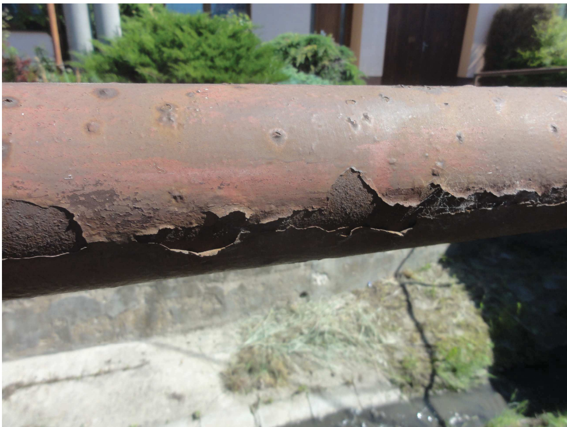
Detail koroze a odlupování barvy
