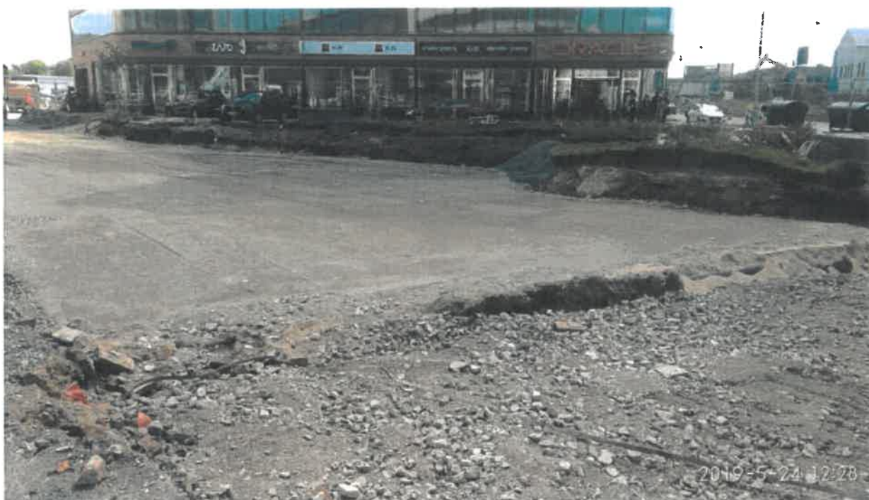
Příloha č.1: Foto – kolize s plynovodem
