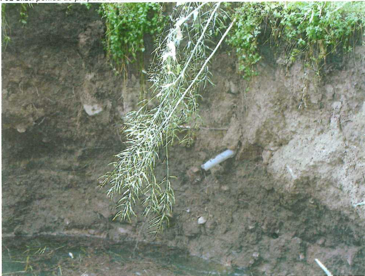
Obr. 02 Bližší pohled do propadu s kanalizační rourou
