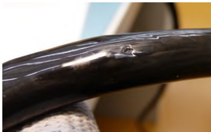
Obrázek 63: Poškozený kabel motoru
