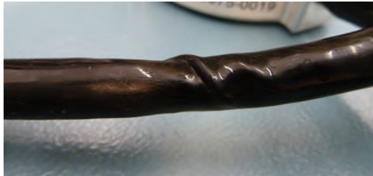
Obrázek 62: Poškozený kabel motoru
