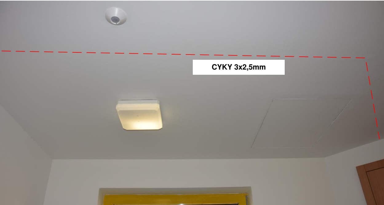
8. 2NP místnost 2.10 Instalace nad sádkartonovým stropem
