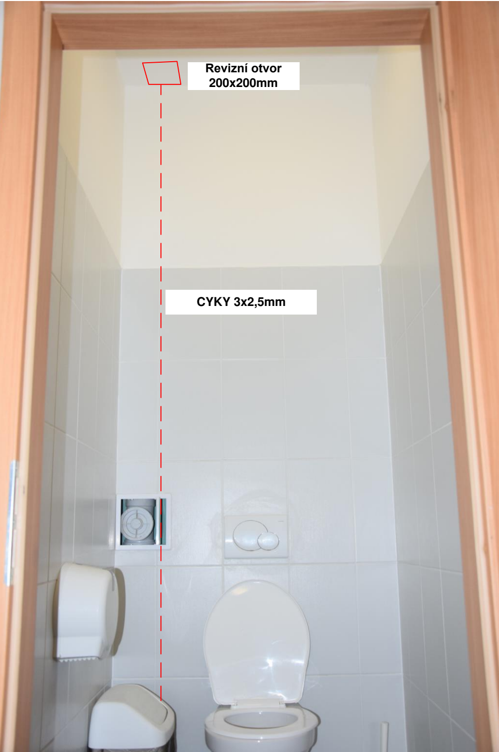
6. 2NP místnost 2.10 Instalace za sádkartoneu ve stoupače
