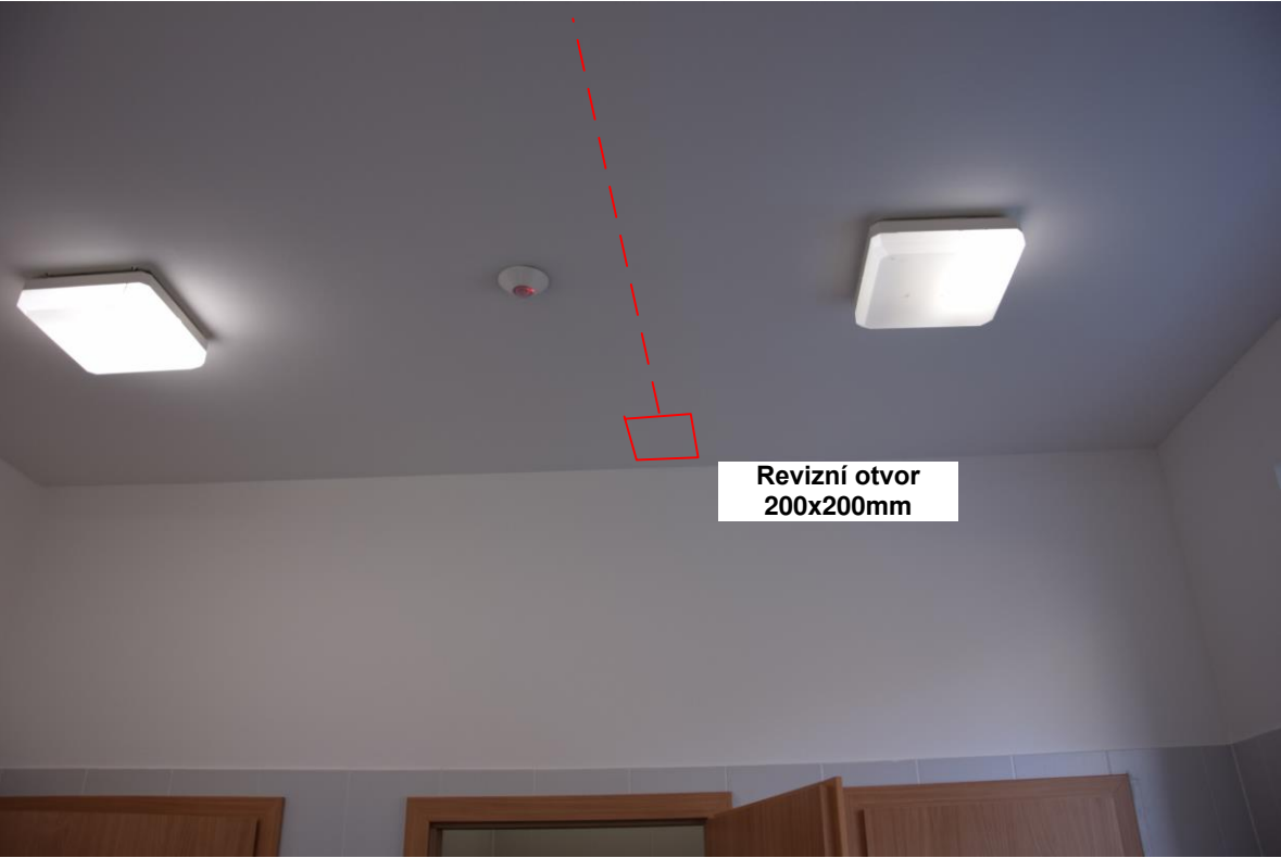
7. 2NP místnost 2.10 Instalace nad sádkartonovým stropem
