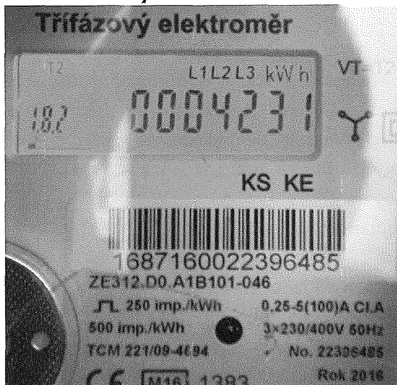
Elektroměr – byt č. 3
