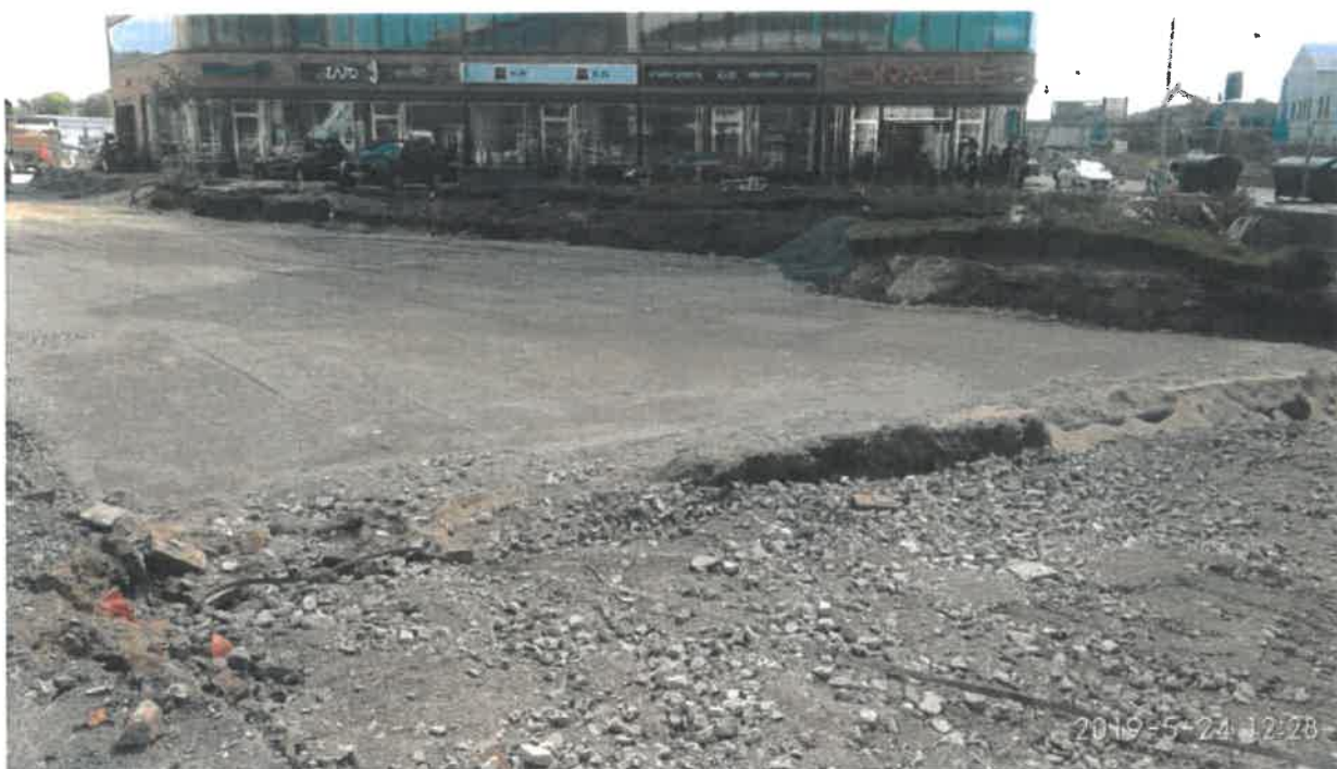
Příloha č.1: Foto – kolize s plynovodem
