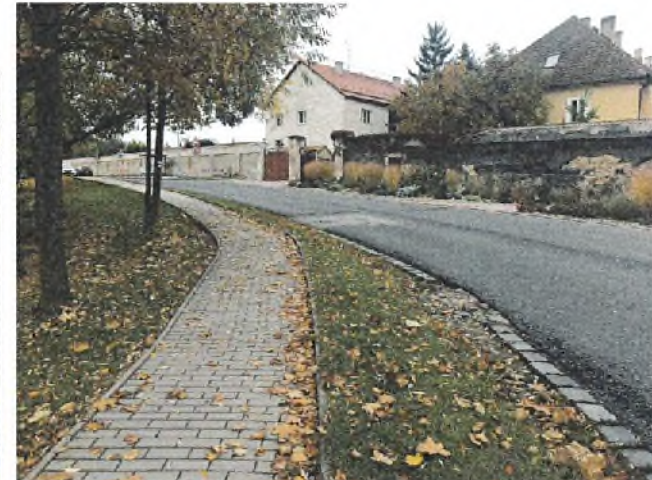
Narušený obrubník v místě, kde po silnici Polabská při deštích stéká velké množství vody. Smišený záhon (trvalky, keře, traviny) na protější straně silnice
