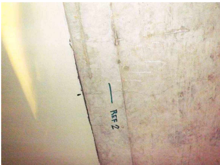
Trhlina č. 53 nalevo u podélníku
