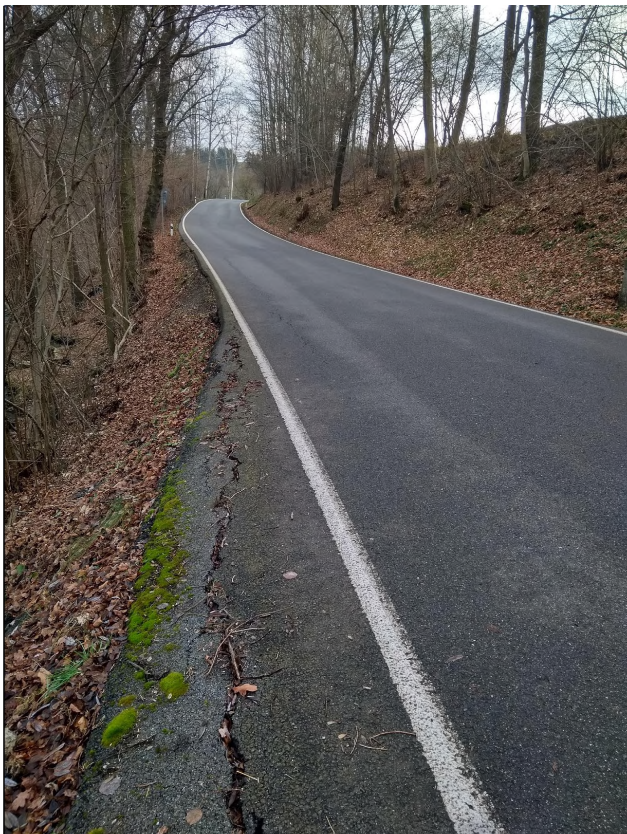
Obrázek 2 Odtrhávající se kraj vozovky
