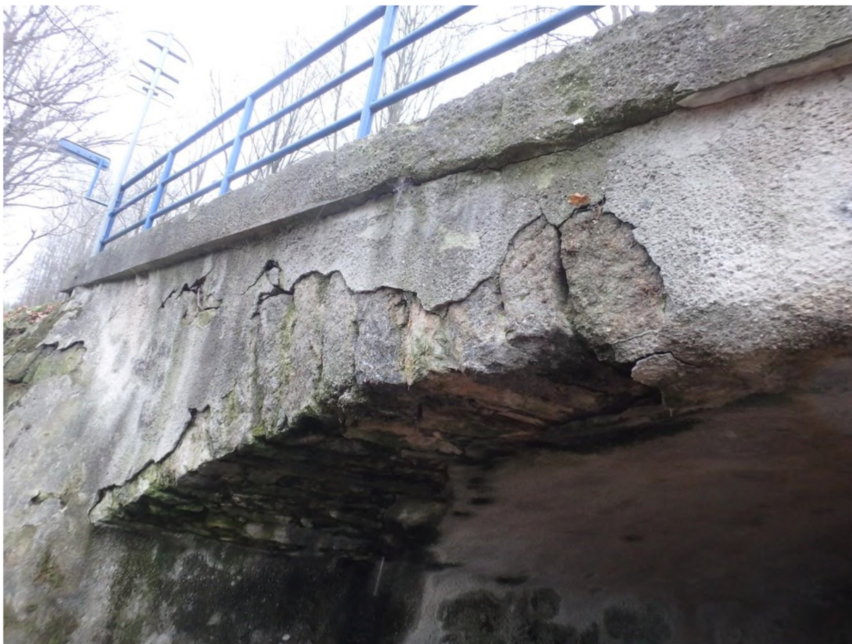
Obrázek 5 Odpadení torkretu na mostu
