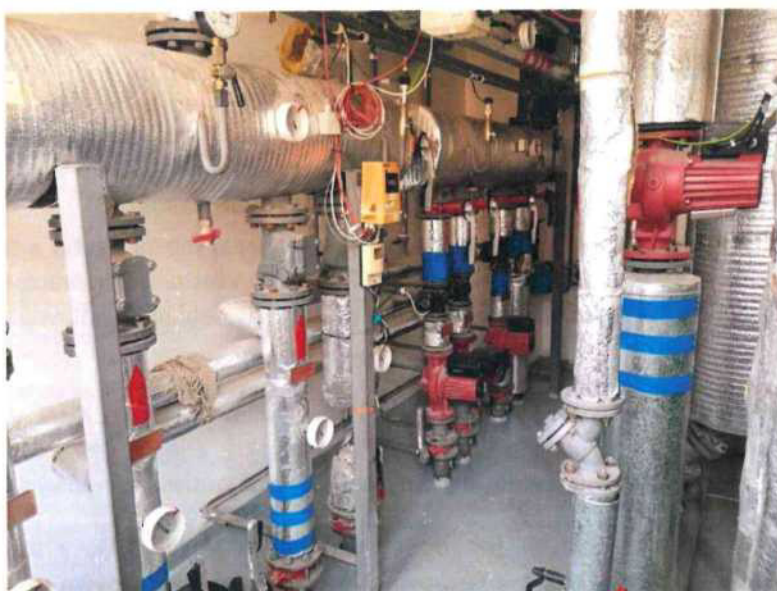
Obr. 2 Stávající směšovací stanice v prostoru ÚKZUK
