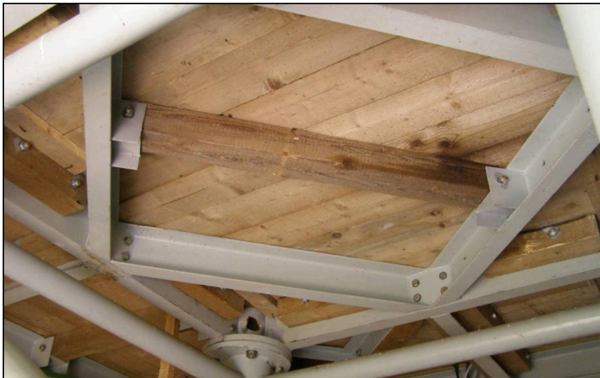
Foto č. 4 - Anténní stožár s nástavbou – detail podlahy horní podesty (pohled na spodní líc)
