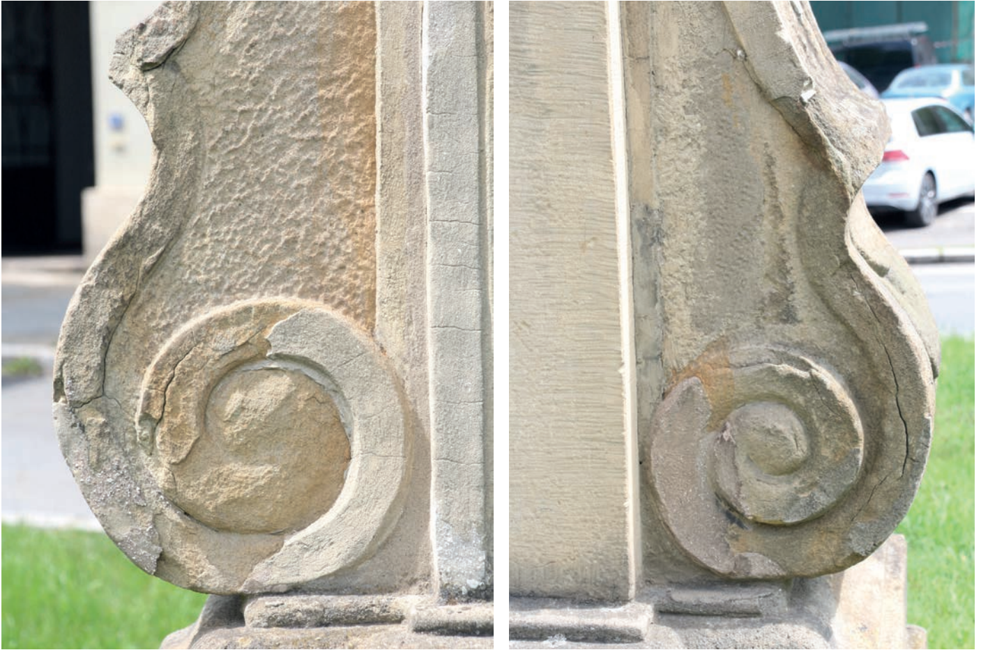
Obr. č. 11-12: Čelní a zadní strana volutového náběhu středního bloku podstavce. Zvětrání kamene, praskliny v kameni, různorodé starší dožívající tmely s nevhodnou barevností a strukturou.
