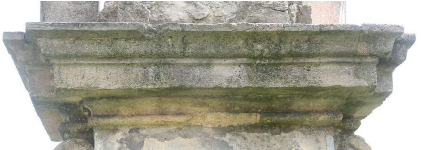
Obr. č. 14-15: Čelní a zadní strana bloku „korunní“ římsy, oddělující spodní část podstavce od horní části s figurálními skulpturami. Silné zvětrání kamene s odpadáváním profilace, znečištění a biologické napadení povrchu, různorodé starší dožívající tmely s nevhodnou barevností a strukturou.
