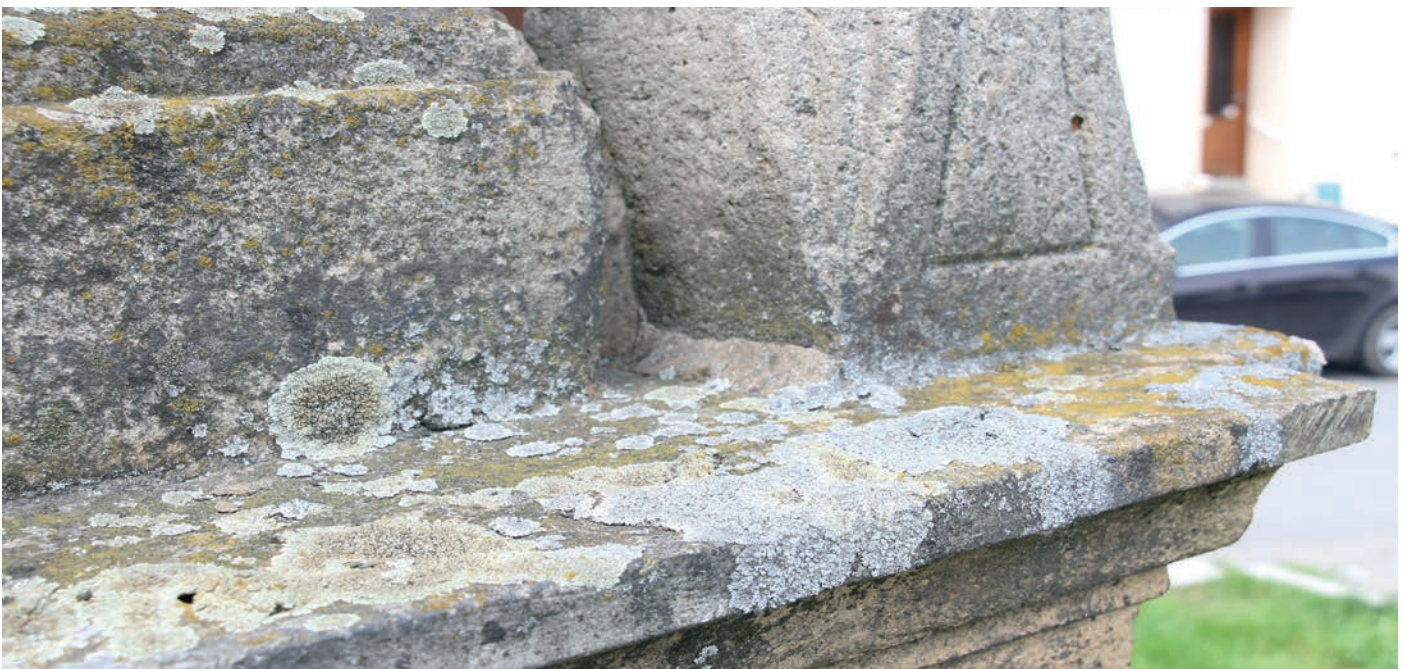
Obr. č. 16: Horní vodorovná plocha bloku „korunní“ římsy, oddělující spodní část podstavce od horní části s figurálními skulpturami. Silné znečištění a biologické napadení povrchu mechy a lišejníky, jejichž vlivem dochází k naleptávání kamene a vydrolování křemičitých zrn.
