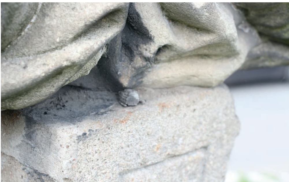
Obr. č. 21: Andílek na sloupku po levé straně sochy P. Marie, sádrovcocvá krusta a vedle dřevěný kolíček ze starší montáže.
