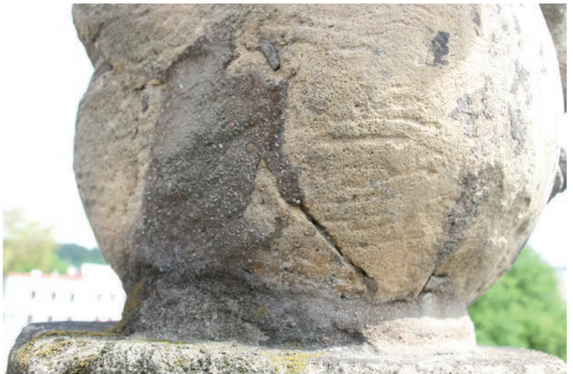
Obr. č. 28: Zadní strana zemského glóbu ovinutého hadem na kterém stojí socha Panny Marie. Viditelná prasklina spodní poloviny glóbu. zatmelená nevhodným cementovým tmelem.
