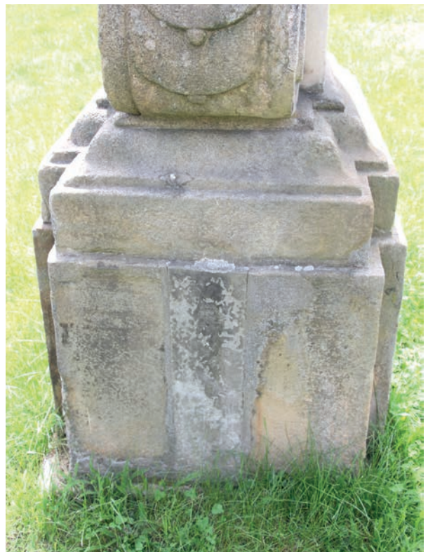
Obr. č. 9: Boční strana spodního bloku podstavce. Zvětrání kamene, starší tvrdé tmely s nevhodnou barevností a strukturou.
