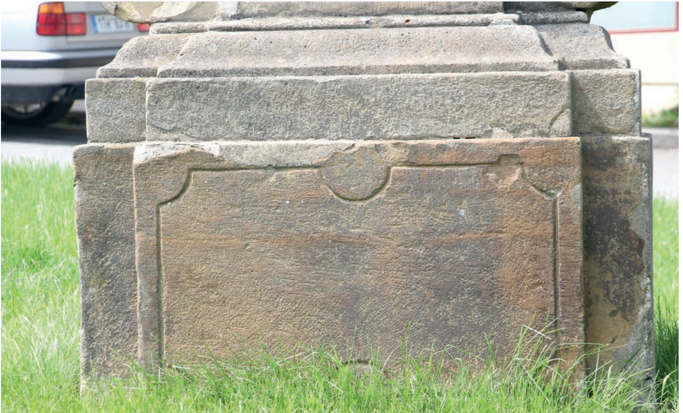
Obr. č. 7: Čelní strana spodního bloku podstavce. Znečištění a mechanické defekty. Starší tmely jsou dožilé.
