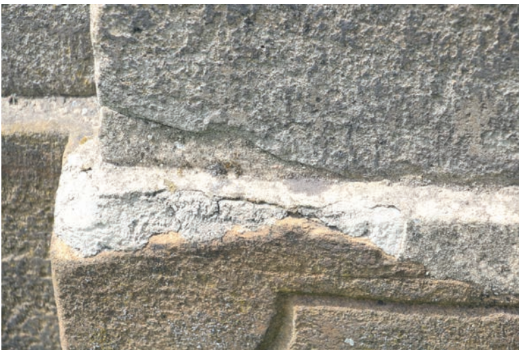
Obr. č. 8: Čelní strana spodního bloku podstavce. Detail rohu s degradovaným tmelem.
