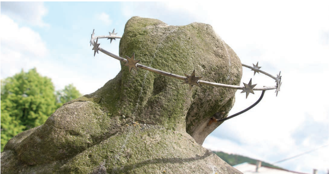
Obr. č. 30: Hlava sochy Panny Marie se svatozáří - zadní pohled. Viditelná prasklina v místě napojení odlomené hlavy, zatmelená dožilým tmelem. Biologické napadení kamene, nečistoty, důlková degradace. Svatozář dochovaná již bez zlacení.
