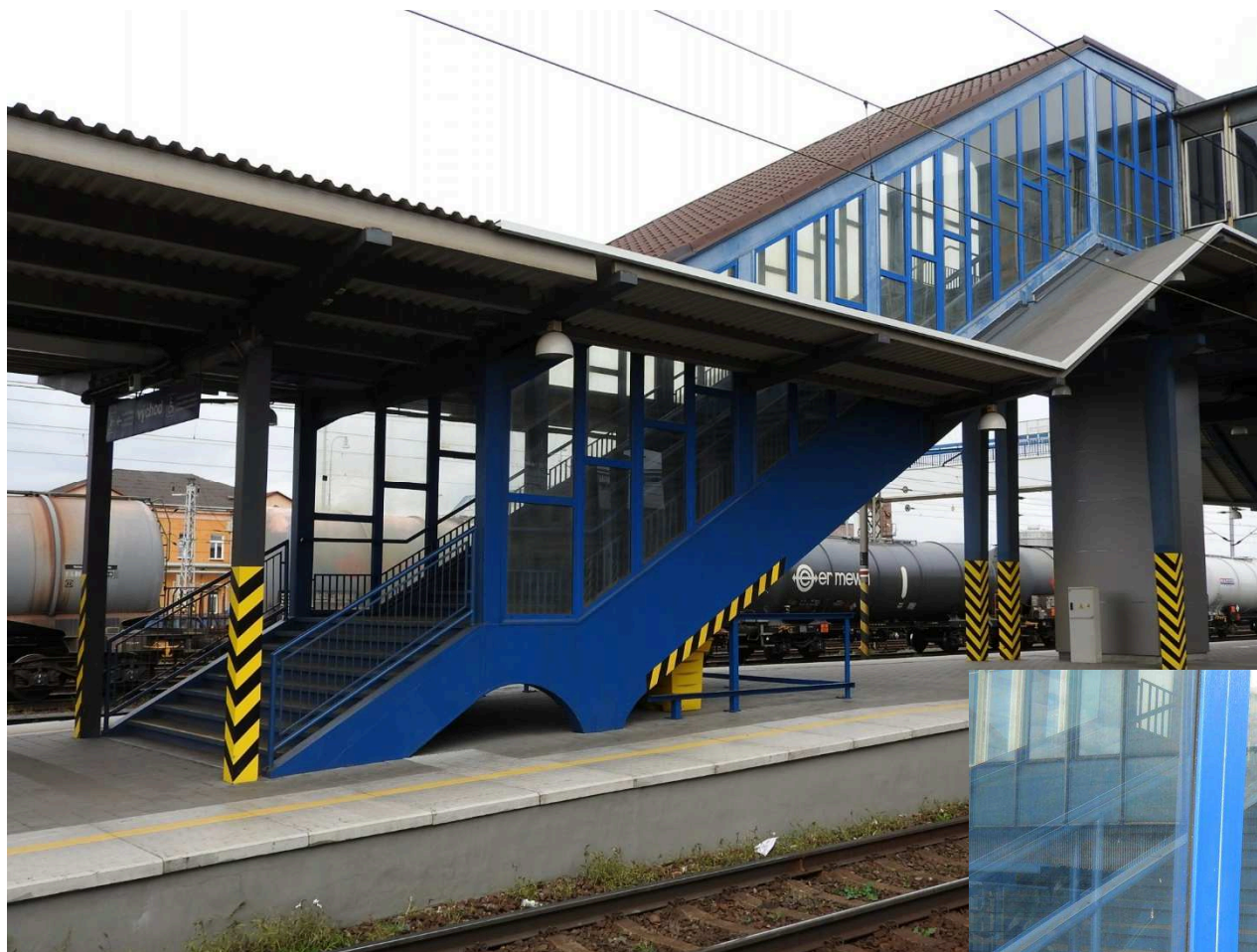
„Oprava mostních objektů v žst. Ostrava hlavní nádraží“, SO 02 lávka km 267,240 (TÚ 1891, DÚ T3) schodišťové rameno směr Ostrava Svinov, poruchy spár - plastový rám x ocelová konstrukce
