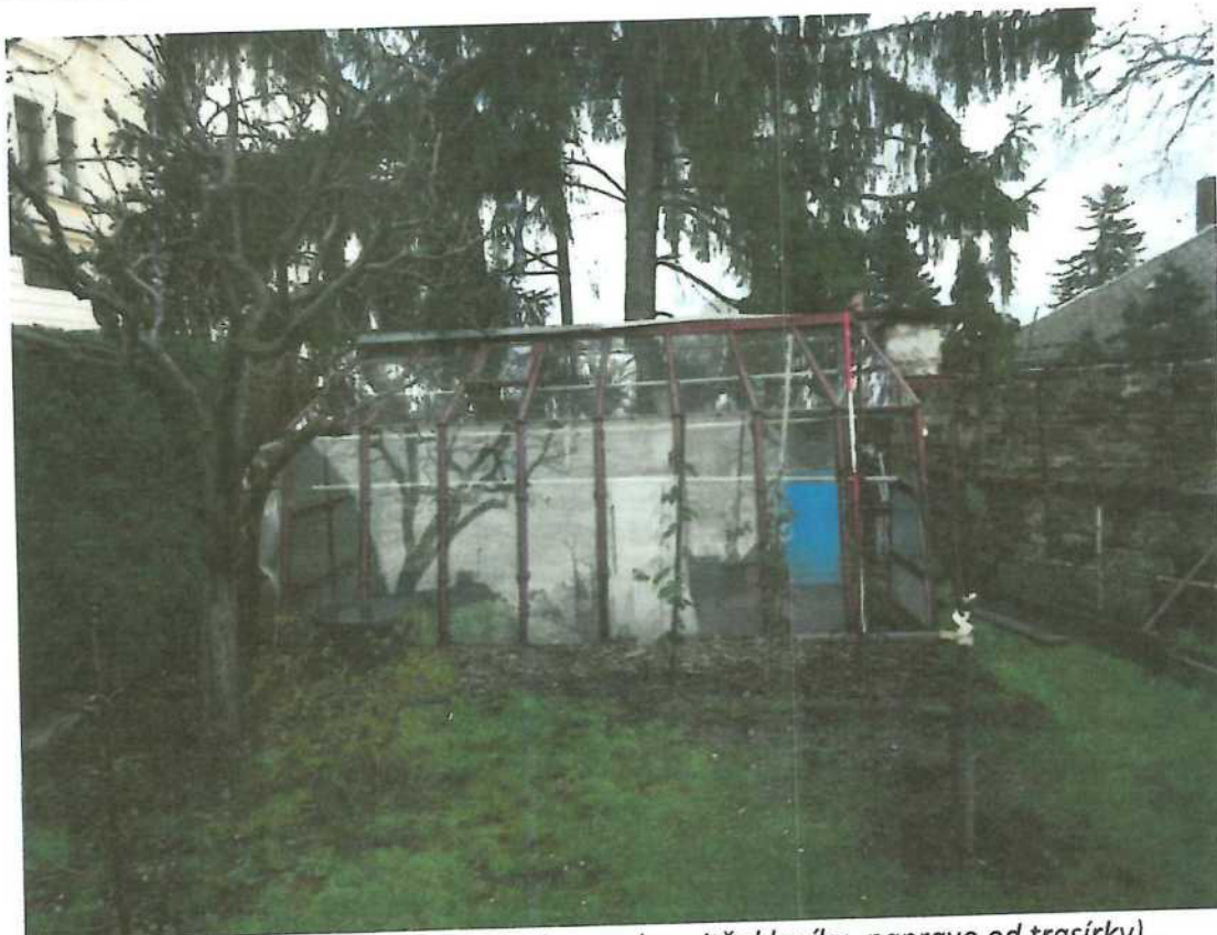
Obr. 01. Celkový pohled na skleník od západu (propad uvnitř skleníku, napravo od trasírky).
