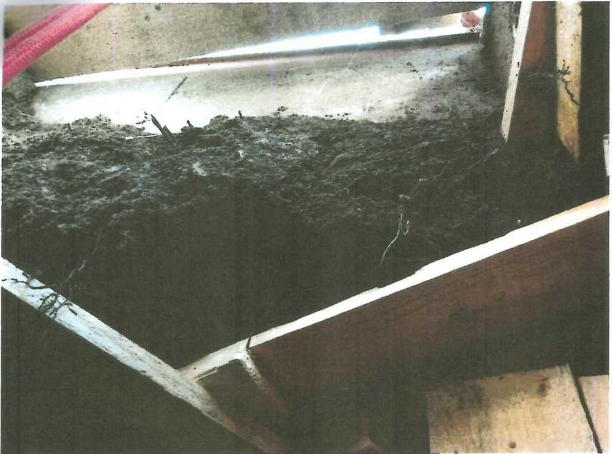
Pohled na zajištění převisu nad propadem pod konstrukcí skleníku
