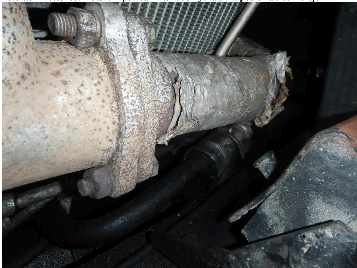
Foto č.3 – netěsnost motoru – potrubí k turbodmychadlu a pod chladičem oleje
