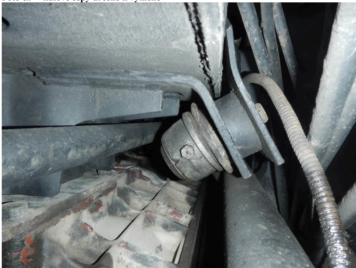
Foto č.9 – kulové čepy určené k výměně
