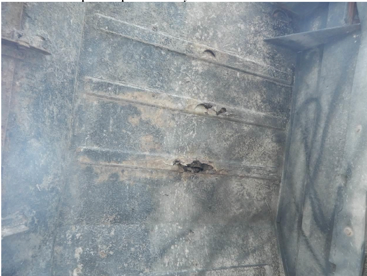
Foto č. 17 – koroze předních podběhů kabiny
