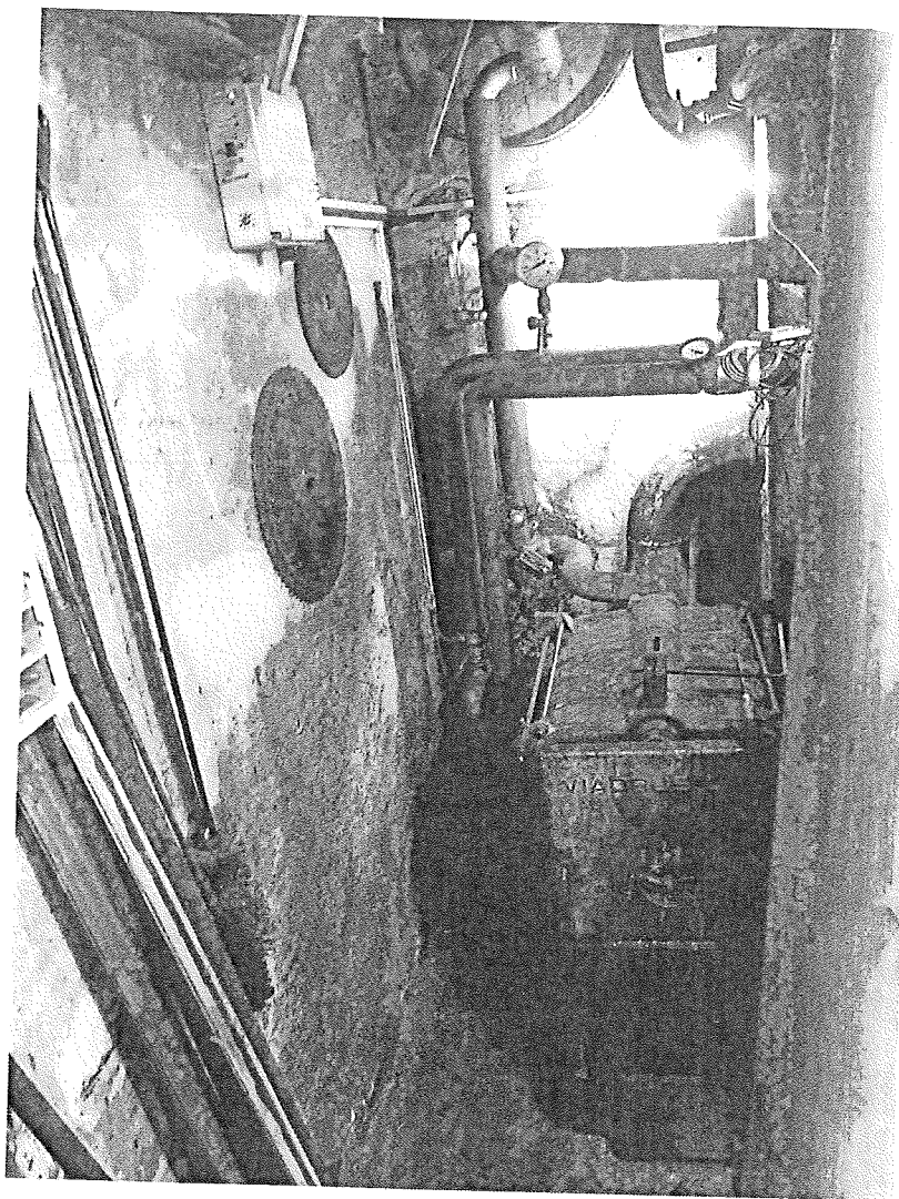
Obr. 1. Kotel pohled zepředu, umístění v kotelně
