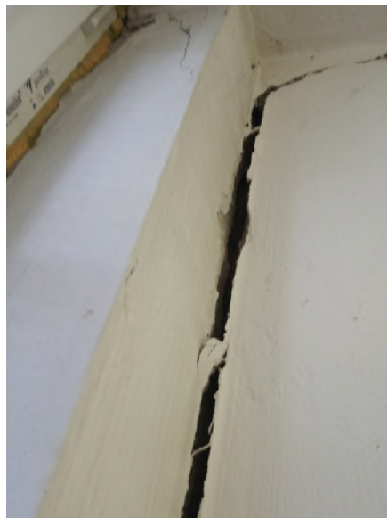
Obrázek 13 - Trhlina v místě styku stěny s příčkou
