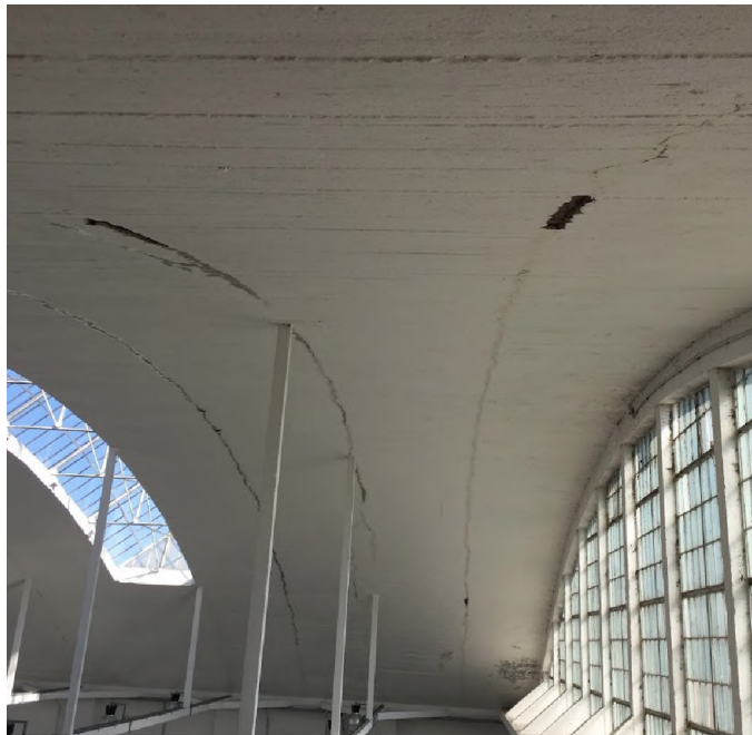
Obrázek 6 - Trhliny ve směru rozpětí klenby
