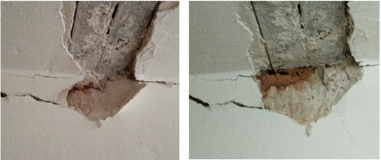
Obrázek 14 - Místo Q4.1, stav před a po odstranění části omítky
