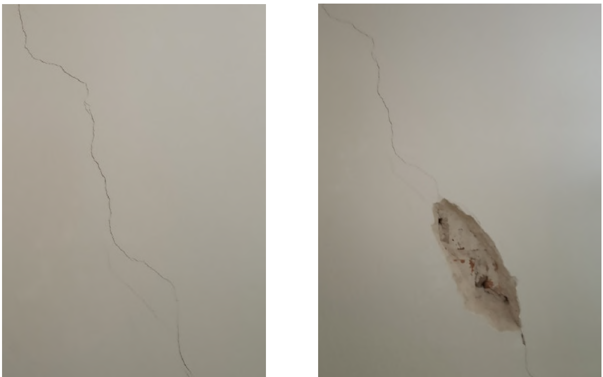
Obrázek 15 - Místo P3.1, stav před a po odstranění omítky
