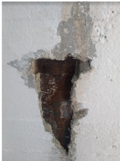
Obrázek 11 - Spodní pásnice ocelového profilu po odstranění degradovaného betonu
