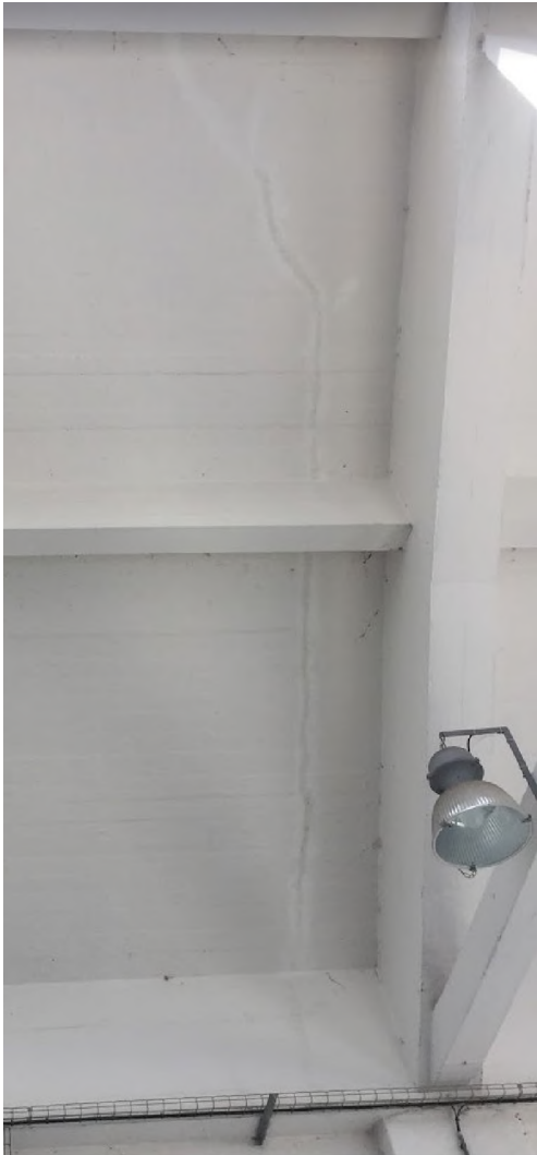
Obrázek 7 – Trhlina v blízkosti průvlaku
