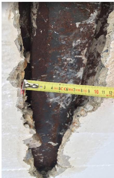
Obrázek 10 – Spodní pásnice ocelového profilu po odstranění degradovaného betonu
