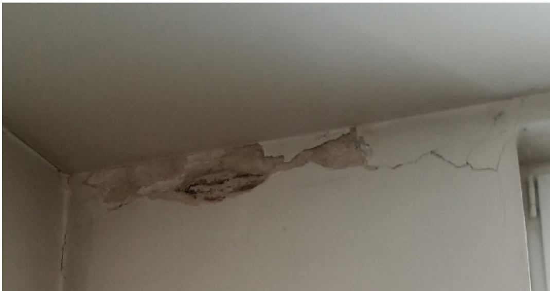
Obrázek 6 - Místo s odstraněnou omítkou, R1.1
