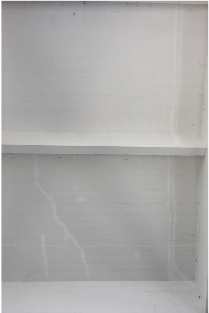
Obrázek 8 – Trhlina v blízkosti průvlaku
