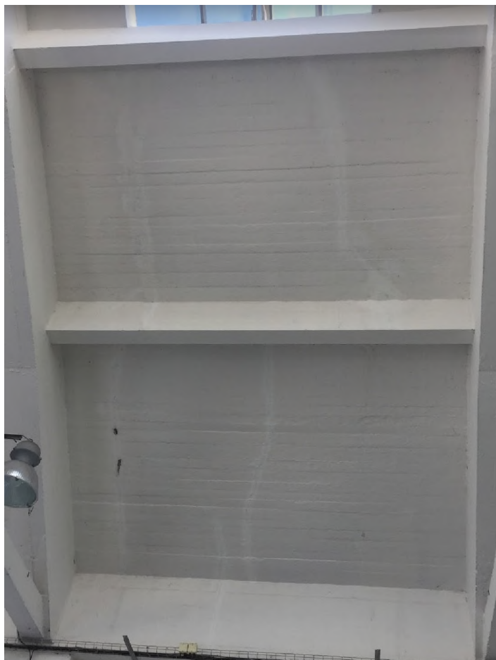
Obrázek 10 – Trhliny v místě světlíku A
