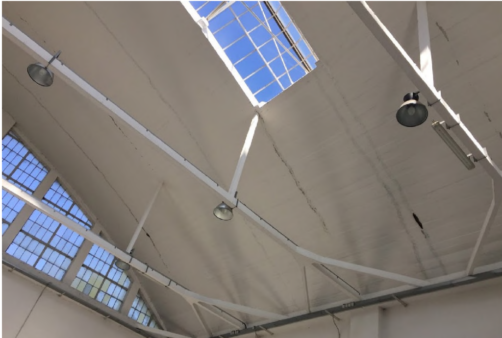
Obrázek 8 – Trhliny v místě světlíku B
