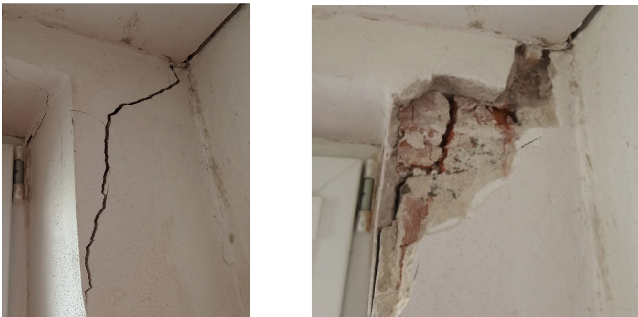
Obrázek 10 – Místo R1.3, před a po odstranění omítky
