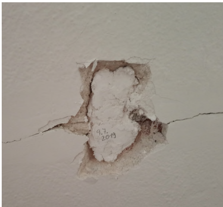
Obrázek 4 - Detail sádrového terče B
