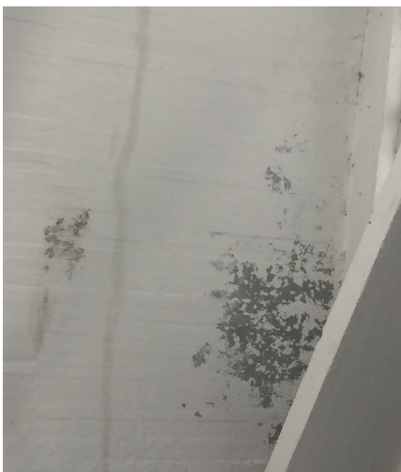
Obrázek 12 – Místo degradované vlivem zatékání
