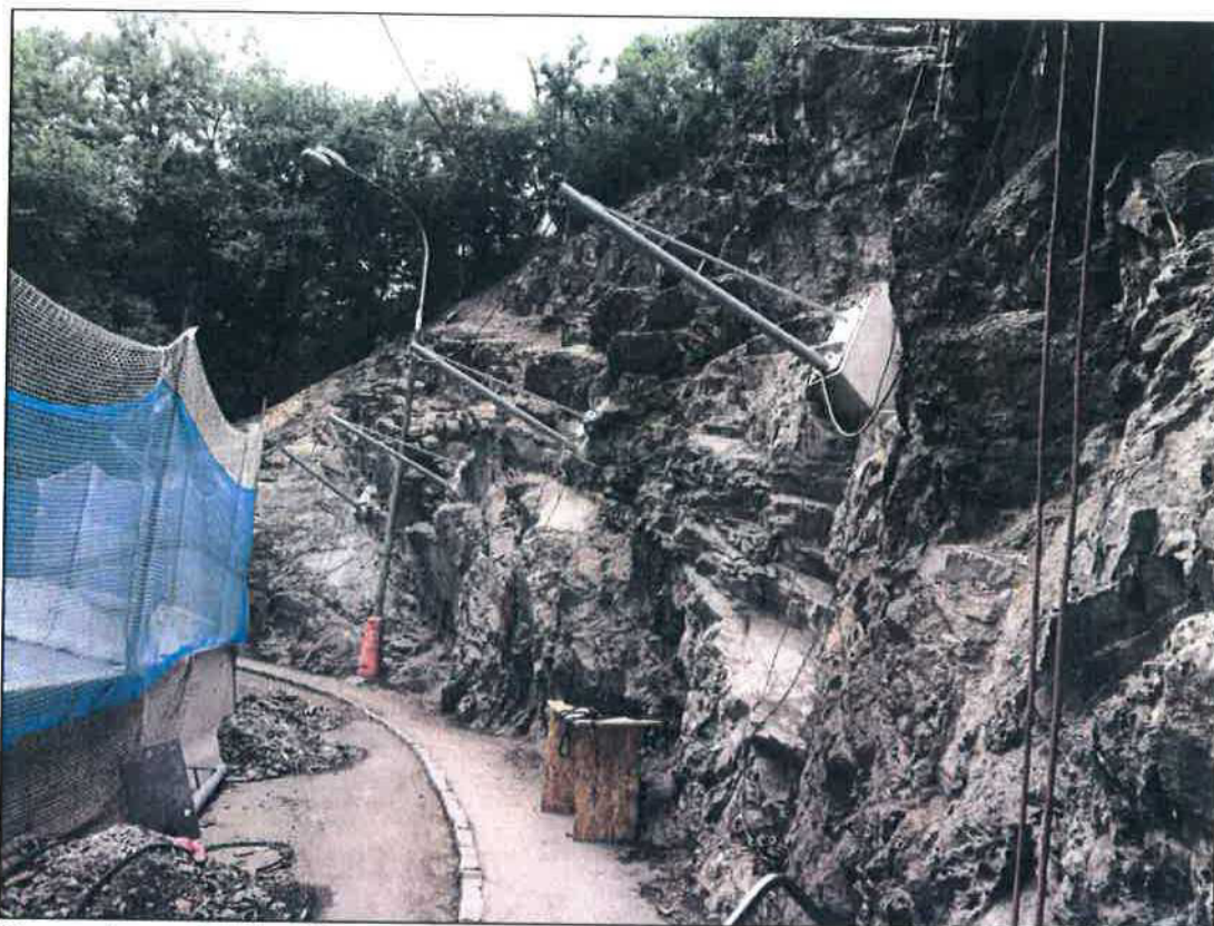
Sloupy dynamické bariéry
