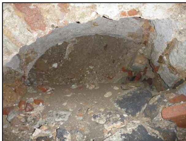
Foto 0250. Ukončení chodby suti a kavernou ve stropě pod objektem čp. 562
