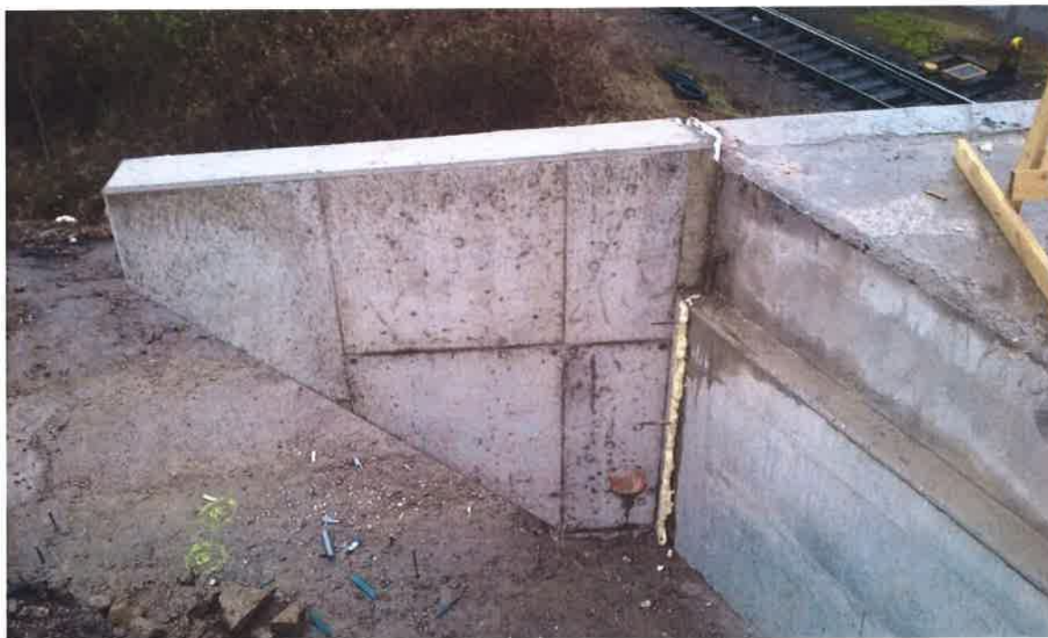
Foto č. 9 - Pohled na rub levého křídla opěry 1 (VP č. 7)
