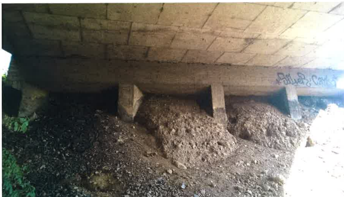
Foto č. 1 – Pohled na prosypanou zeminu opěrou 1 (VP č. 4)
