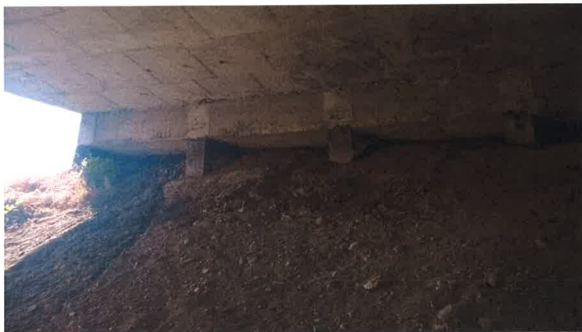
Foto č. 2 – Pohled na prosypanou zeminu opěrou 4 (VP č. 4)
