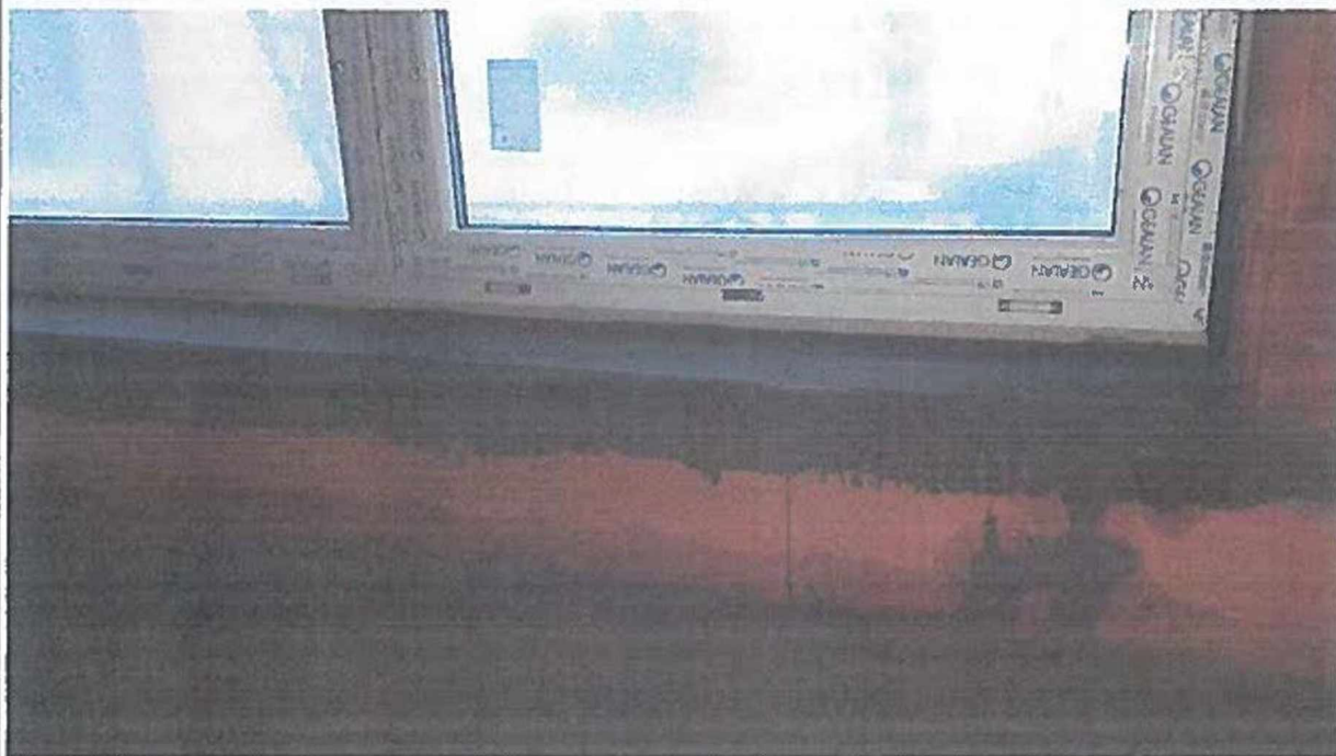
Obezdění izolace acelového nosníku pod oknem, vyrovnání tloušťky a síťování stávajícího zdiva a nového (dole).
