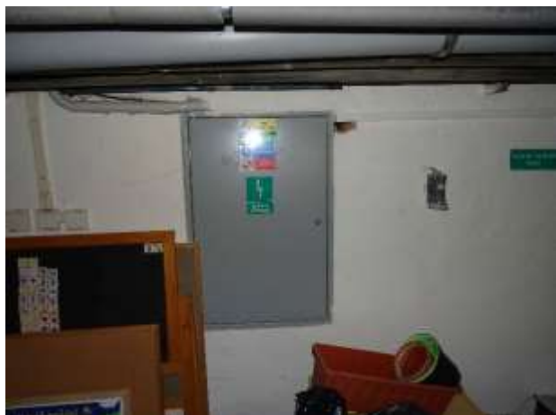
EST.1 – umístění rozvaděče pro napojení sirény v suterénu starší budovy
