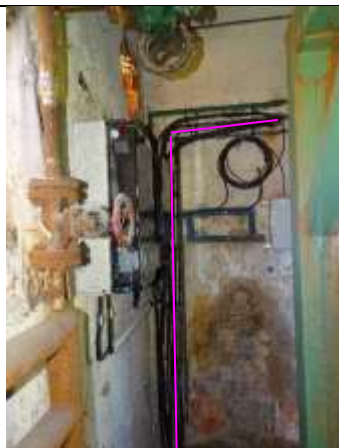
Obr. P2-13 – stávající trasa od průřezu do kabelového kanálu budovy výměníku (kabel CYKY-J 3x2,5 po urovnání doplnit na přichytky)
