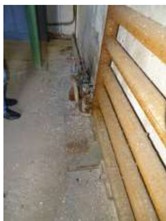
Obr. P2-15 – stávající trasa v kabelovém kanále budovy výměníku
