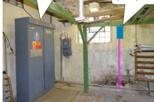
Obr. P2-16 – umístění elektroměrového napájecího rozvaděče pro měření a jistiání (1f/16/B) nového přívodu rozvaděče převaděče VIS
