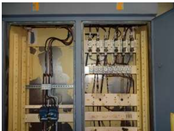
Obr. P2-17 – stávající rozvaděč RM110, vnitřní uspořádání
