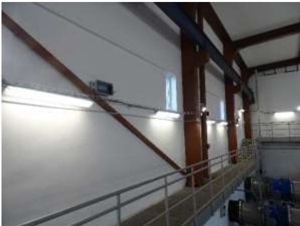
EST.11 – boční stěna kde bude ve stávajícím drátěném žlabu vedena nová kabelová trasa k novému stožáru sirény
