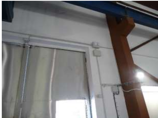
EST.11 – boční stěna kde bude kolem vrat vedena nová kabelová trasa (el.trubka 40) k novému stožáru sirény
