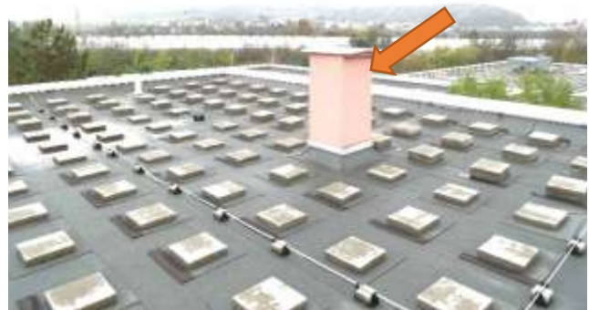
ESN.16 – nefunkční komín kterým budou vedeny všechny kabely k siréně
