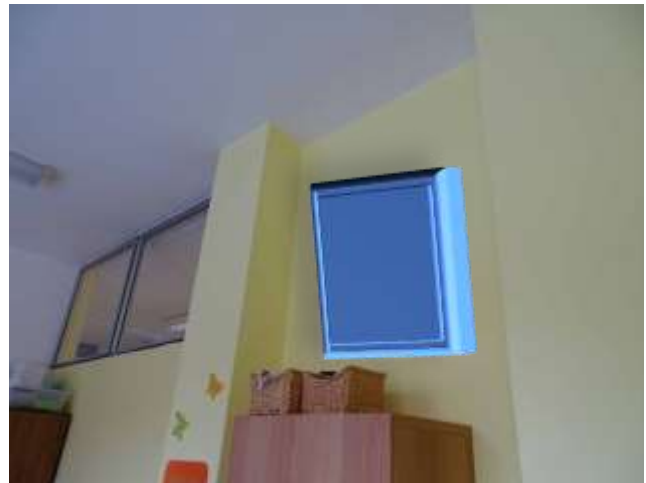
ESN.16 – umístění nového rozvaděče sirény /sousedí s nefunkčním komínem kterým budou vedeny kabely na střechu/
