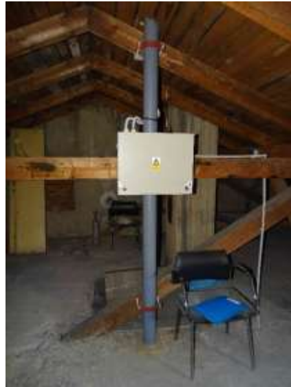
ESN.16 – umístění rozvaděče stávající rotační sirény, v podkrovním prostoru
