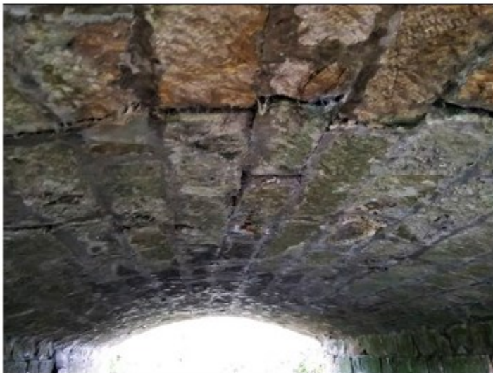
Poruchy v pohledu NK
