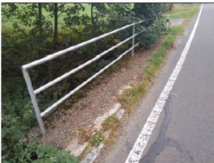
Uspořádání na výtokové římse
