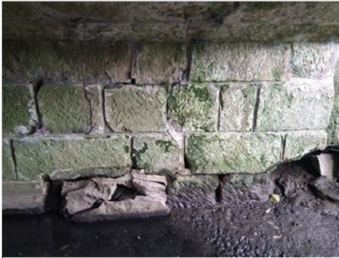
Poruchy v líci opěr
