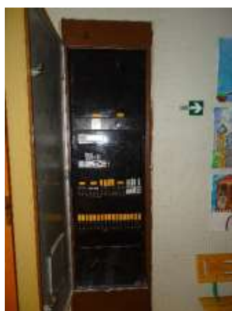
Obr. P4-7 – stávající patrový rozvaděč R2-A ve 2.NP
