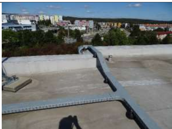
Obr. P4-9 – stávající trasa anténních kabelů na střechu
