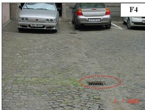
Dešťová kanalizace uvnitř objektu - dvůr.
