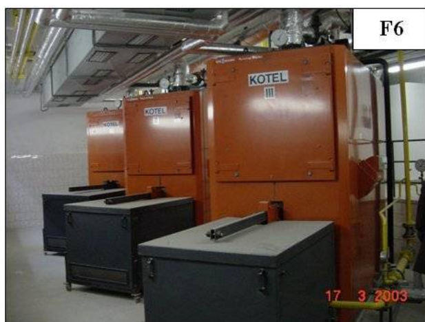
Plynové kotle - kotelna, druhý suterén.
