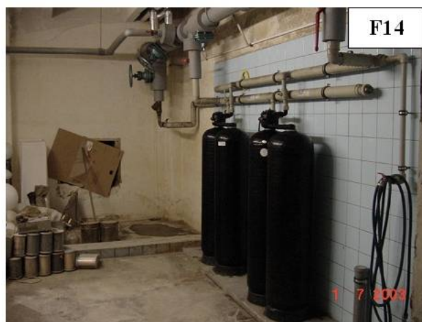
Hlavní uzávěr vody a úpravna vody – druhý suterén, č. d. 7A. (a 56), viz Metodika uzavírání přívodu vody
